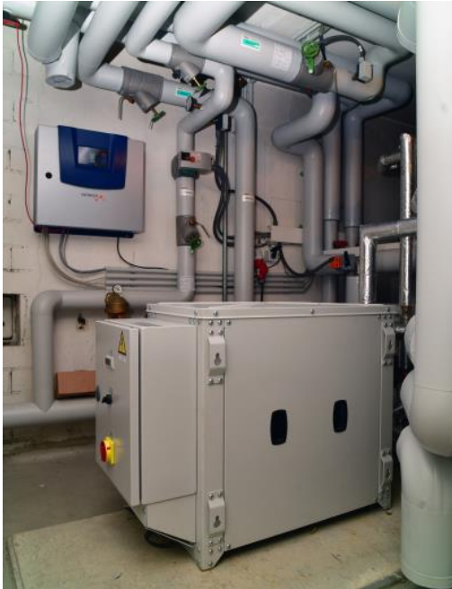
eXergiemaschine mit Regelung (oben links im Bild) (Bild: Stadtwerke Augsburg, Fotograf: Thomas Hosemann)
