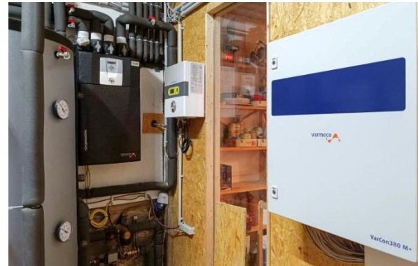
Die eXergiemaschine (schwarzes Gerät links im Bild) hebt die von der Wärmepumpe gelieferte Temperatur auf zirka 65 °C an. Der Systemregler (rechts) dient der Überwachung aller Quellen und optimiert die Heizkreise.
