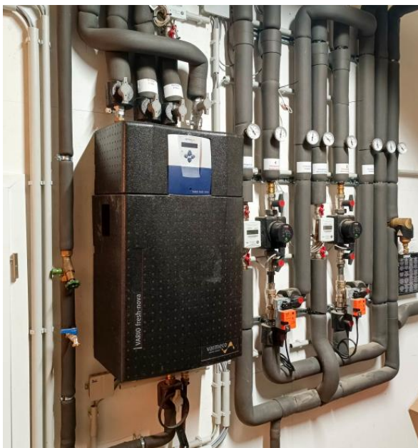
Zur neuen Heizanlage gehört auch ein hydraulischer Durchlauferhitzer (schwarzes Gerät). Er nutzt die Wärme des Heizspeichers, um frisches Trinkwasser zu erhitzen. Dabei sind Heizkreis und Trinkwasser strikt getrennt.
