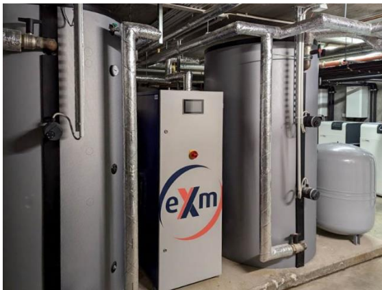
... und der eXergiemaschine, welche die hohen Temperaturen für die Warmwasserbereitung herstellt.
