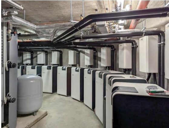
Heizungsraum des größten der neun Gebäude mit den Heizungswärmepumpen...
